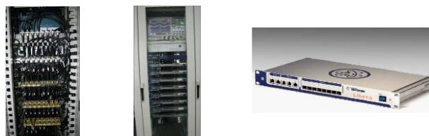
技术走廊束测本地站 数字化BPM处理器 电缆转接端子
